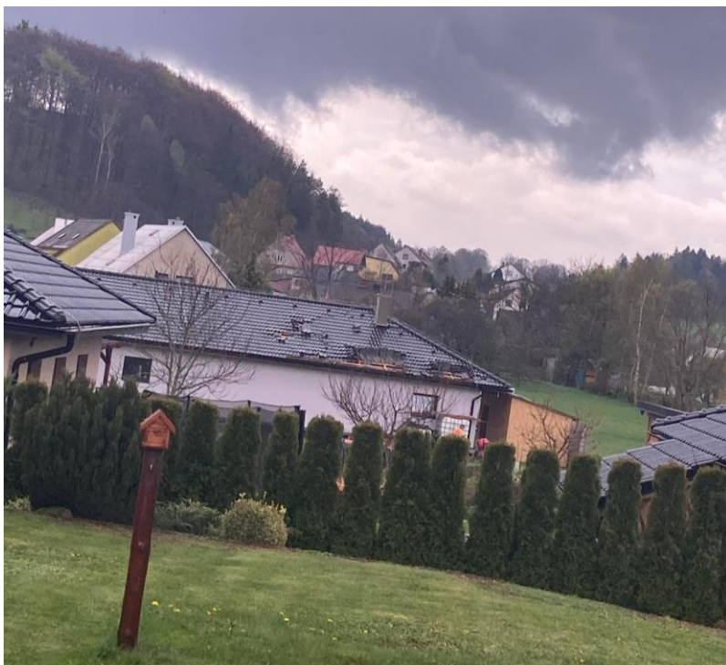
Foto 3: Střecha tornádem nejvíce poškozeného domu v obci Lubná. Autor: Markéta Bednářová.
